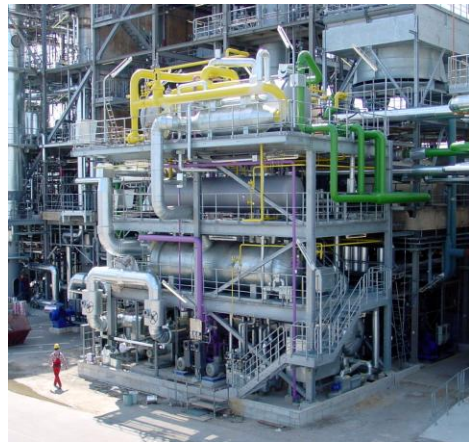
Abwärme nutzende Kälteanlage zur Kühlung eines Zwischenproduktes einer Kunststoffproduktion in einem Chemiekomplex der BASF in Schwarzeide
