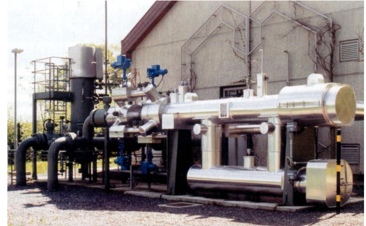
Wirbelrohranlage zur Erdgastrocknung der Thyssengas GmbH in Gronau – Epe, NW.
