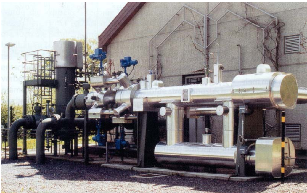
Fig. 21: Wirbelrohranlage zur Erdgastrocknung der Thyssengas GmbH in Gronau – Epe, NW.
