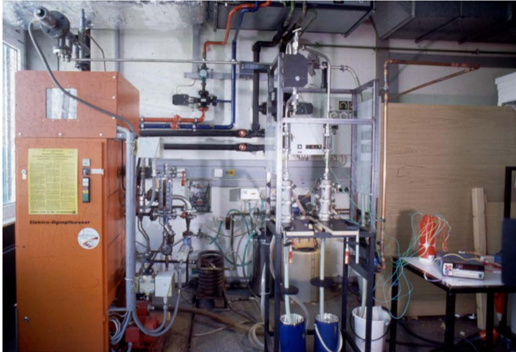
Fig. 8: Versuchsanlage zur Expansion von Wasserdampf bis p_{\max} = 20 bar im Wirbelrohr [26]. Das eigentliche Wirbelrohr ist in Bildmitte oben in lotrechter Anordnung zu erkennen. Links im Bild die Dampferzeugungsanlage.
