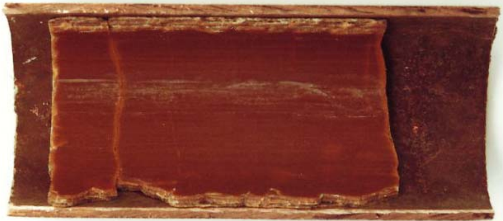
Warmwasserleitungsrohr Betriebszeit: 6 Jahre
