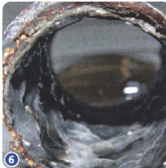
Biofilm im Abflussrohr
